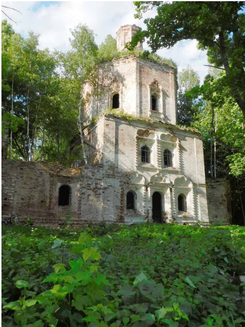
Разрушающаяся церковь Михаила Архангела (1712 г.). Место гнездования серой неясыти. Нежилое с. Дуняни, Локнянский район
